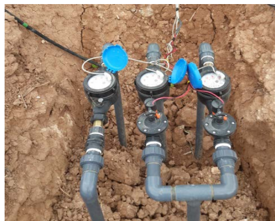
Control del sistema de riego mediante contadores automatizados y electroválvulas capaces de ajustar la programación de agua a las necesidades hídricas de los cultivos.
